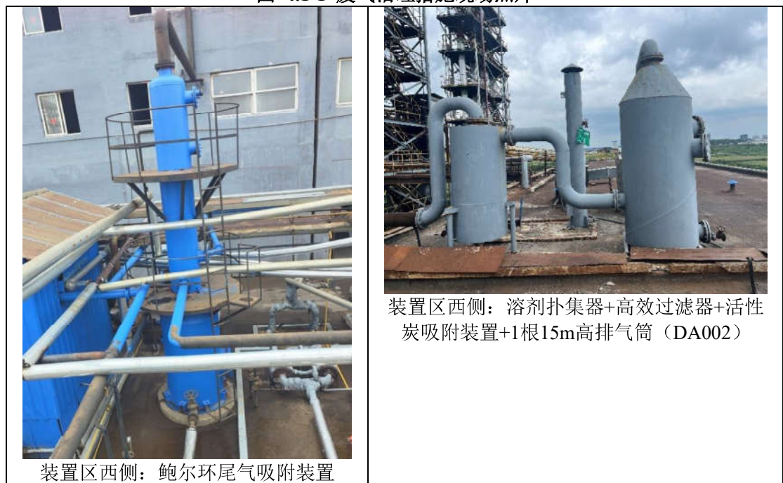
图 4.1-1 废气治理措施现场照片
