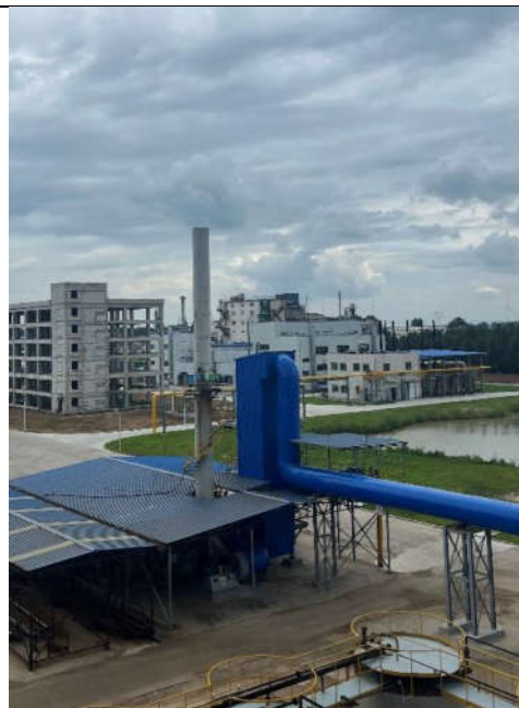
1套SCR脱硝系统+1根20m高排气筒（DA001）
