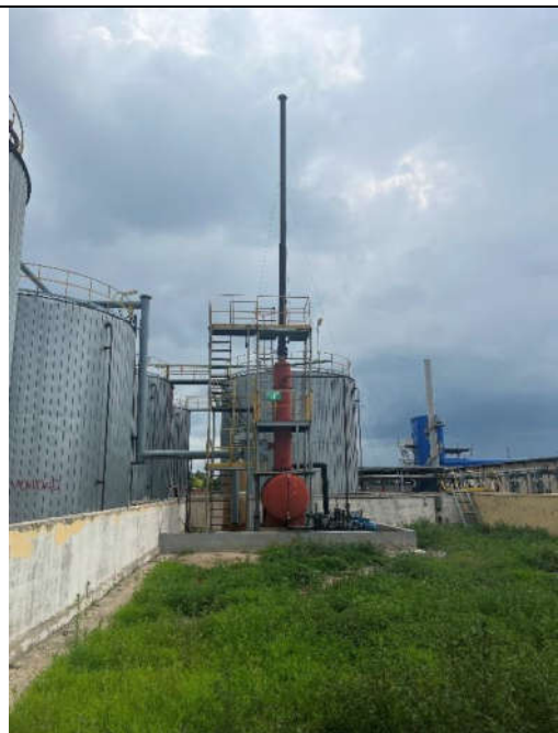
罐区废气和装载废气：罐区废气经高效过滤器+活性炭吸附装置处理后有组织排放；装载区有机废气经集气罩收集后高效过滤器+活性炭吸附装置处理后与罐区处理后的废气共用1根15m高排气筒（DA004）有组织排放
