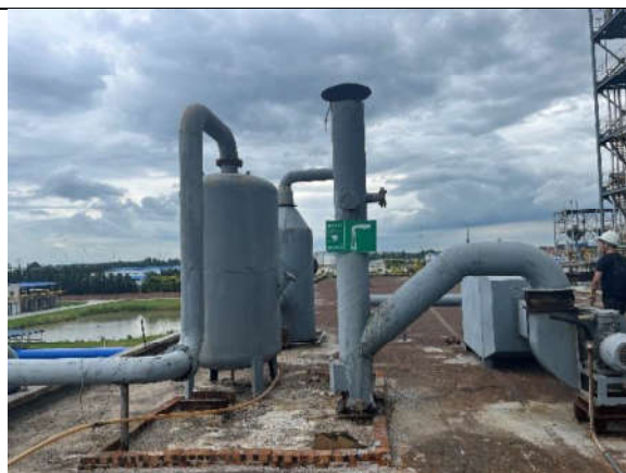
装置区东侧：溶剂扑集器+高效过滤器+活性炭吸附装置+1根15m高排气筒（DA003）
