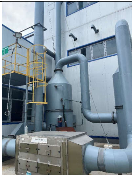
水喷淋+二级活性炭吸附+DA006排气筒
