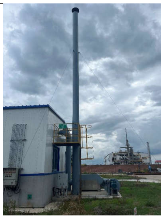
危废间治理措施活性炭吸附+DA015排气筒
