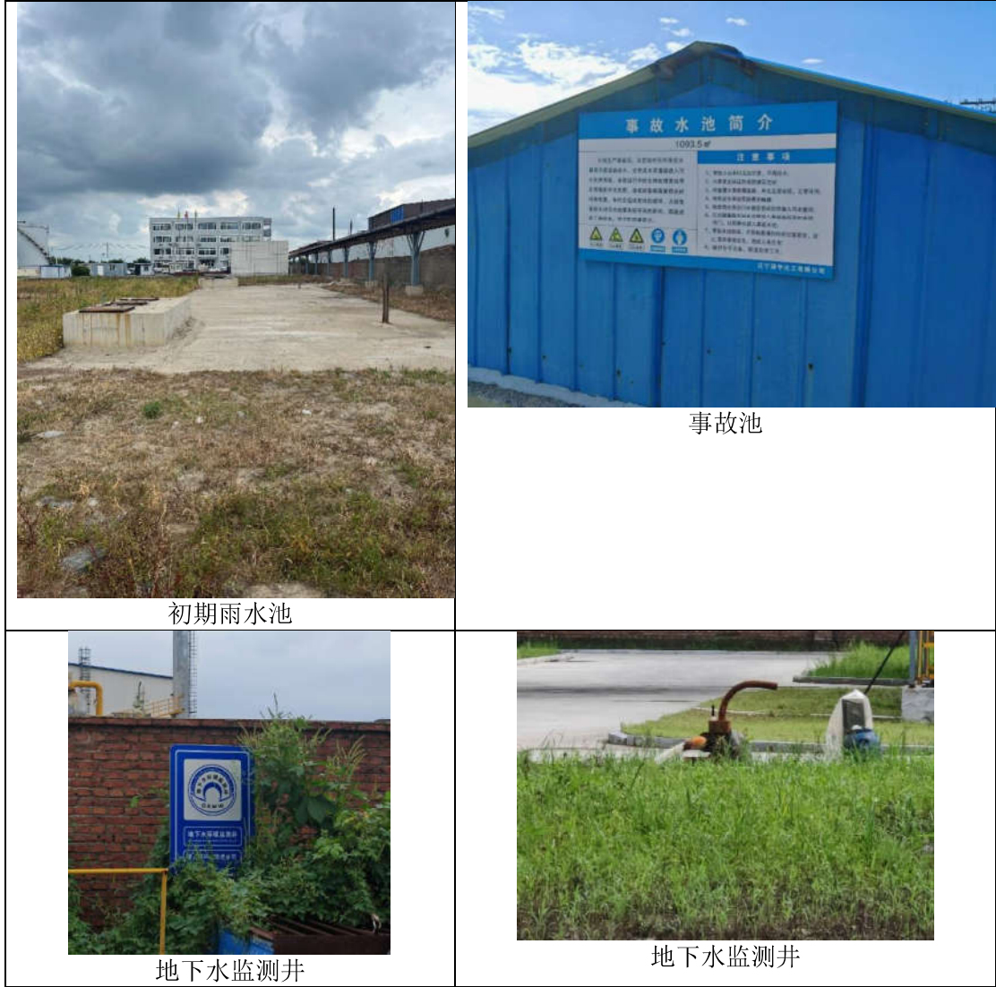
图 4.2-1 风险措施现场照片
